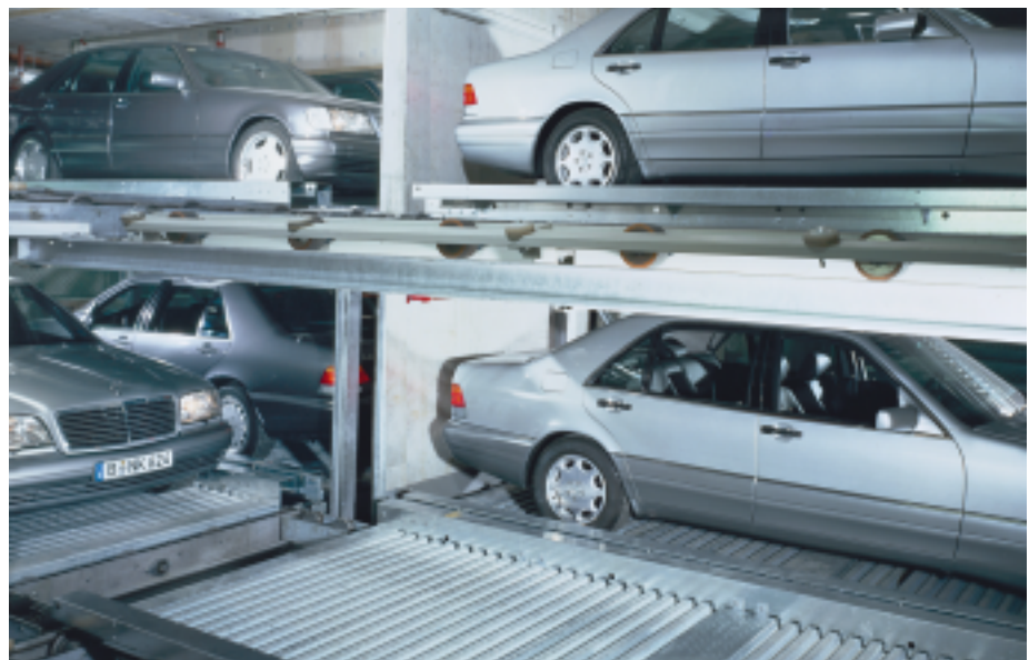
Die neueste Wöhr-Parktechnologie im Pietzsch-Haus: 36 Stellplätze eng zusammengedrückt auf 2 Ebenen im Untergeschoß – ohne Rampen und Fahrgassen. Ein- und ausgefahren wird im Einfahrtsraum auf Straßenniveau – alles andere geschieht automatisch. Alle 70 Sekunden kann ein Fahrzeug vom Vertikalförderer auf einer Palette ins Parksystem einsortiert werden, eine Drehscheibe bringt es wieder in Ausfahrposition – eine kompakte, sichere und umweltfreundliche Lösung.
