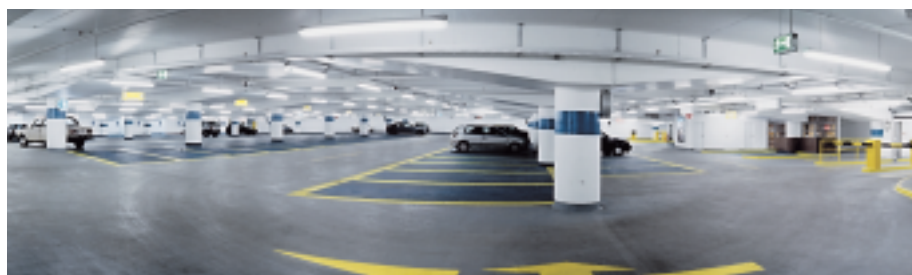
Beispiel für eine gut ausgeleuchtete Tiefgarage: Der erste Eindruck zählt. Foto: Wöhr + Bauer GmbH, München
