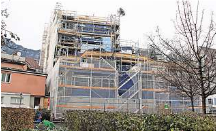
Neben dem Restaurant Bären wurde inzwischen der Bau Centralstrasse 1 hochgezogen. Bild: Werner Geiger
